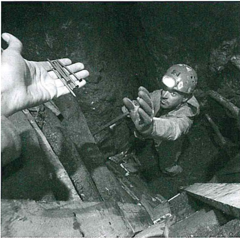
I primi lavori di costruzione del Pozzo Tauledda a -20m (foto C. Corongiu)
